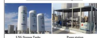
LNG Storage Tanks Pump station
